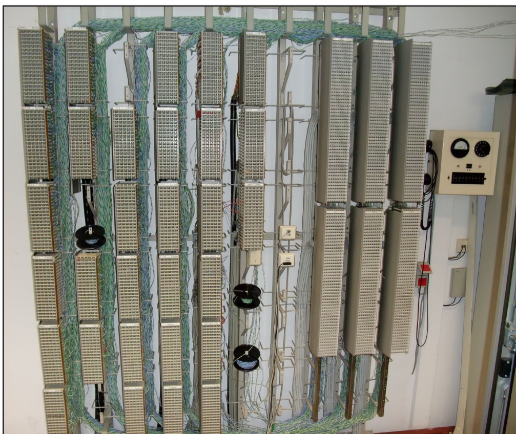
Der alte Telefonverteiler vor der Abschaltung mit „nur noch“ 3000 Telefonanschlüssen. Foto: Holger Meyer
