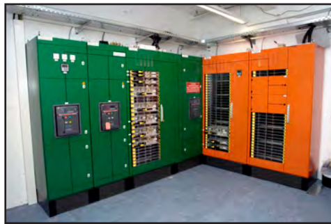
Bild 2: Der neue NSHV-Raum, die Niederspannungshauptversorgung des URZ. Foto: Benjamin Bollendorff
